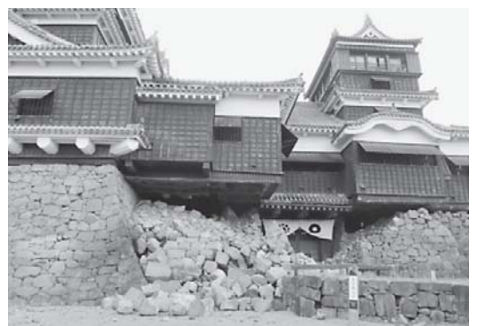
熊本地震で熊本城も崩壊
