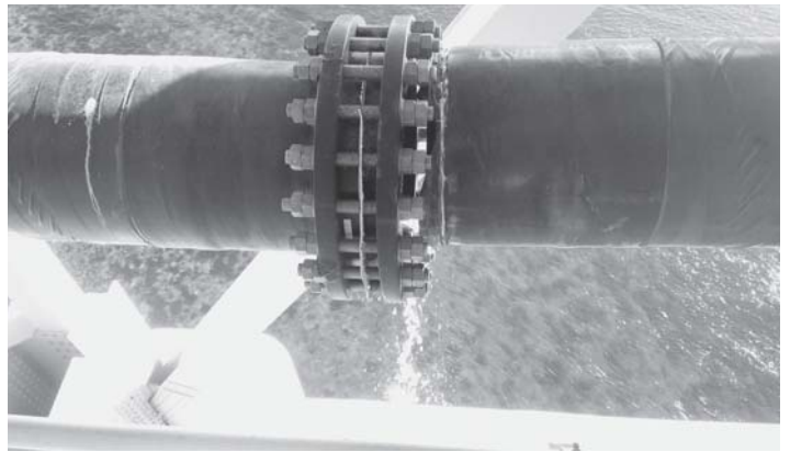
破断した水道管（大島大橋下部）
