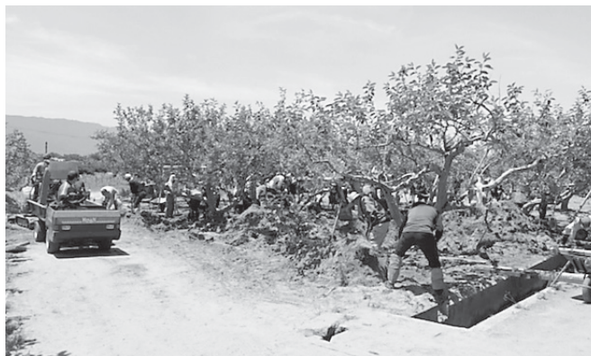
人海戦術で土砂の撤去作業 (朝倉市杷木志波)
