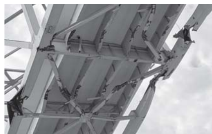
橋桁の損傷 (10月29日撮影)
