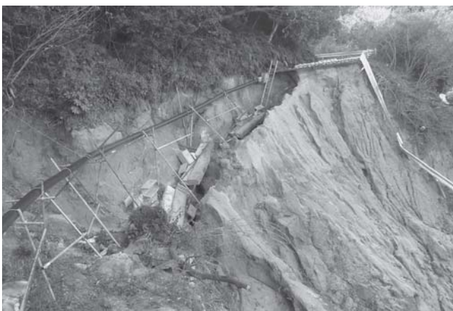
崩落した浮島の町道
