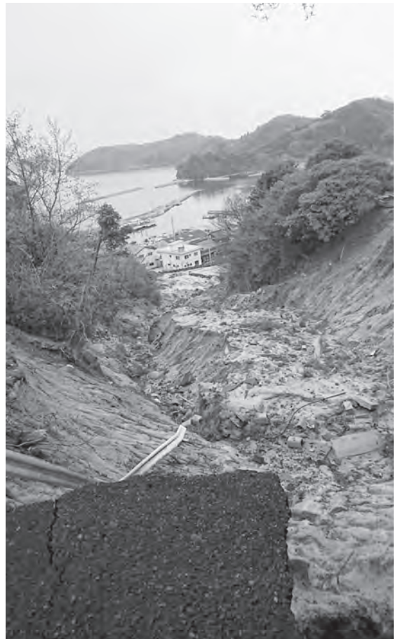
手つかずのままの崩落力所
