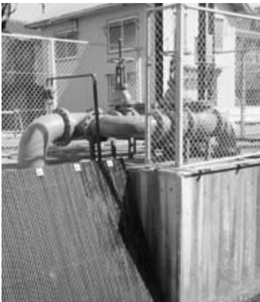
石丸排水ポンプ (小松)
