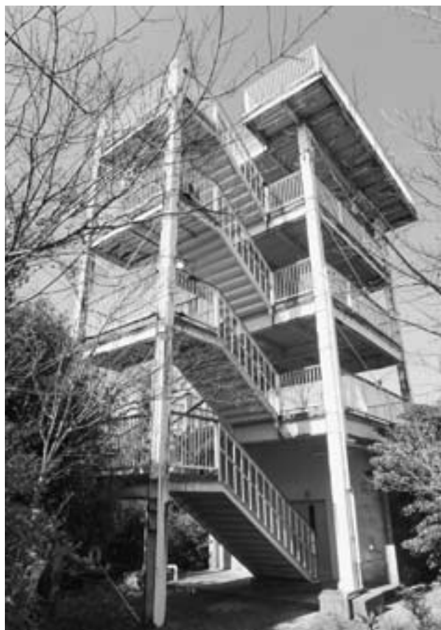
▲老朽化が進む飯の山展望台
