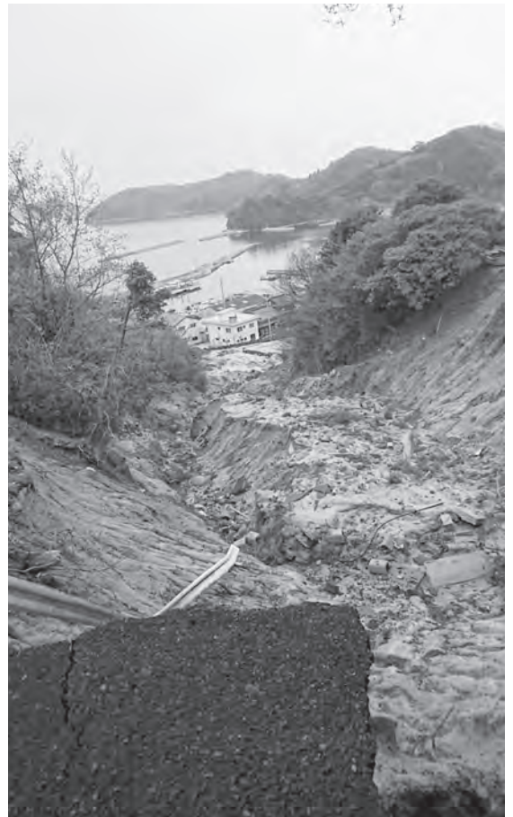
手つかずのままの崩落力所
