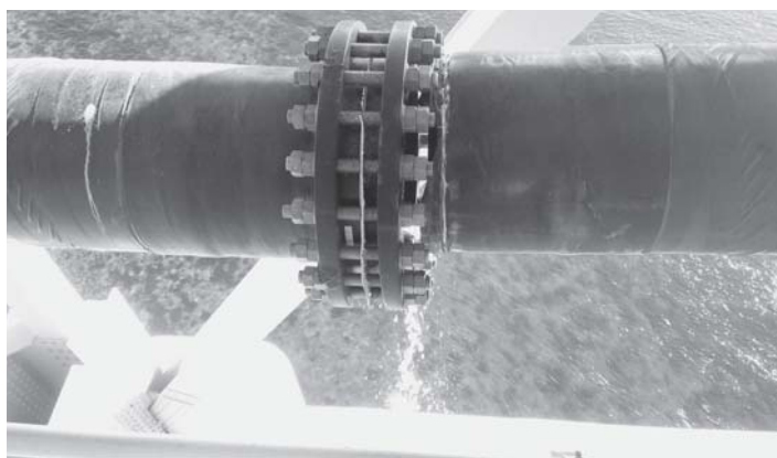
破断した水道管（大島大橋下部）
