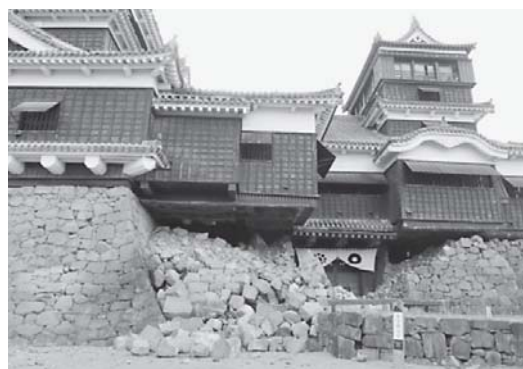
熊本地震で熊本城も崩壊
