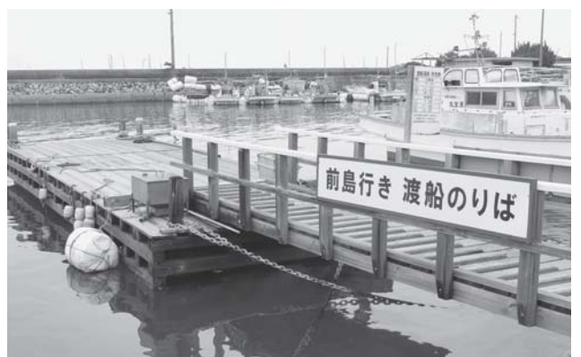
▲ 老朽化した前島行き渡船乗り場の浮き棧橋
