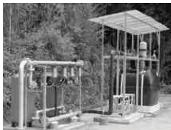
▲ 液肥混入施設
