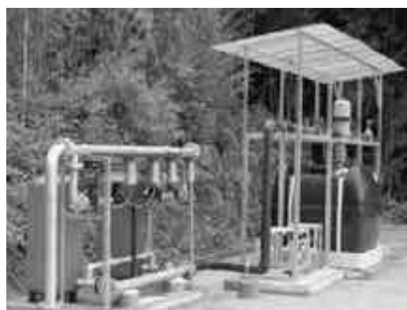
▲ 液肥混入施設
