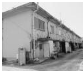
老朽化した町営住宅
