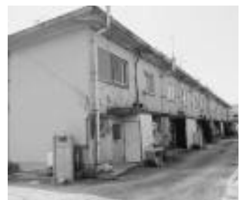
老朽化した町営住宅
