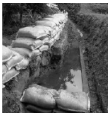
改修が待たれる水路
