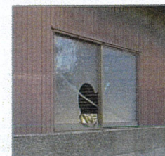
窓が割れた管理不全空家
