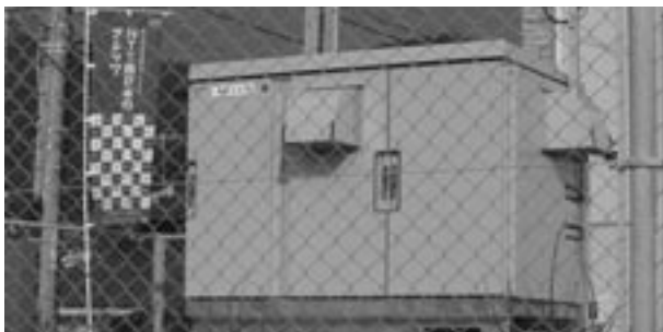
沖浦局に新しく建設されたADSL提供設備
