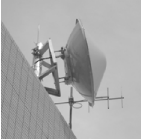
久賀庁舎に設置されたアンテナ。
