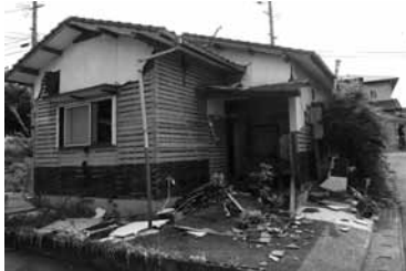
▲被害家屋の様子
